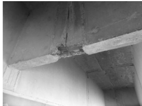
图 5 T 梁横隔板破损
