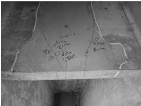
图 4 T 梁横隔板裂缝
